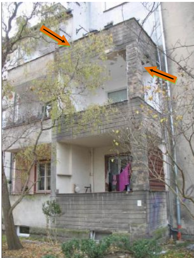
Fot.1 Widok ogólny na balkon nad 1 piętrem przynależny do mieszkania nr 7 Ubytki tynków płyty balkonowej od spodu wraz z odkrytym widokiem belek stalowych Płyta balkonowa jest nieszczelna.
