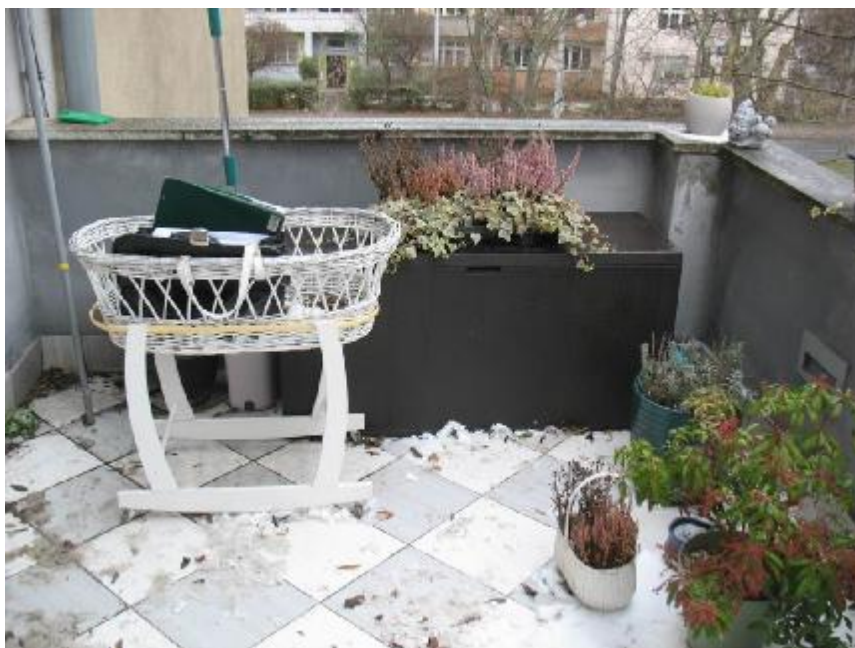
Fot.2 Widok na balkon od strony wewnętrznej Balustrada istniejąca ma wysokość ~80cm nad posadzką . Zgodnie z aktualnymi wymaganiami należy ją podwyższyć do wysokości ~1,10m nad posadzką
