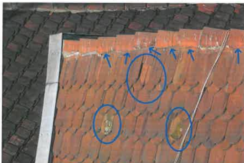
Fot. 4.3. Dachówki są nasiąkliwe i łuszczące się, wiązania gqsiorów są luźne
