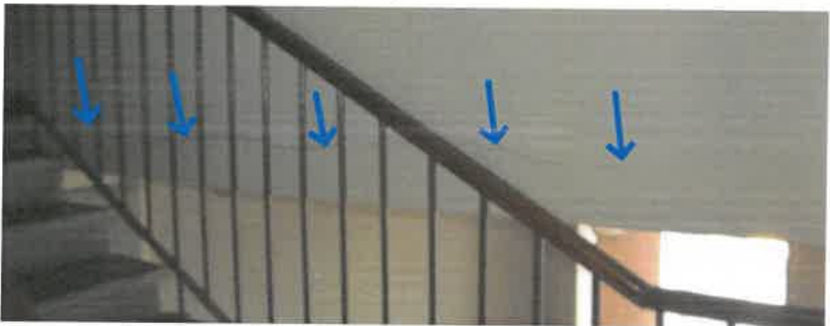
Fot. 4.16 – zarysowania ścian w rejonie wejścia na poddasze - w klatce schodowej Więzienna 30
