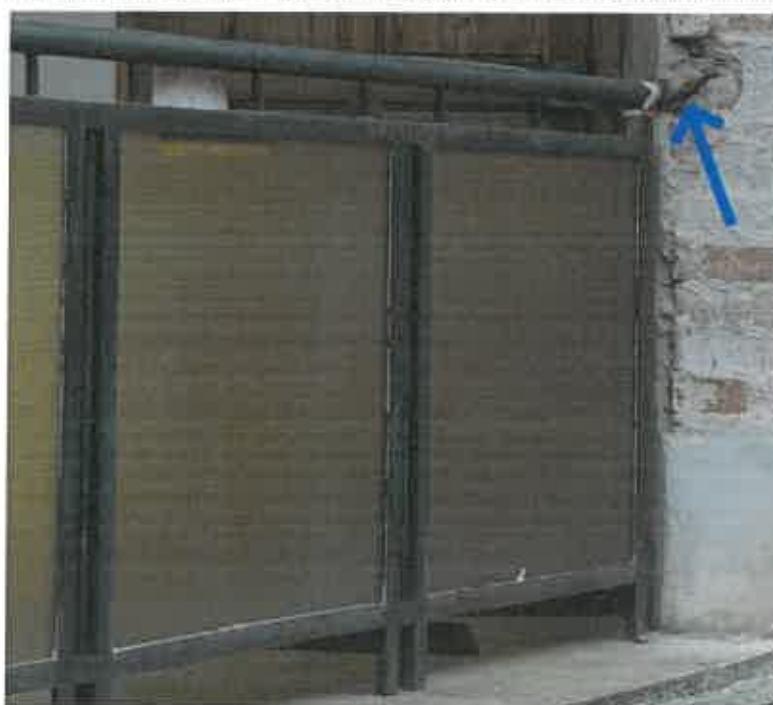
Fot. 4.32 – Na galerii na 2 piętrze stwierdzono uszkodzenie kotwienia stalowego pochwyty balustrady w murze elewacyjnym
