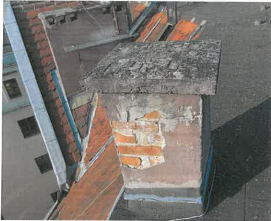
Fot. 4.9. Na większości kominów stwierdzono odparzenia i odspojenia tynków o zróżnicowanym stopniu.
