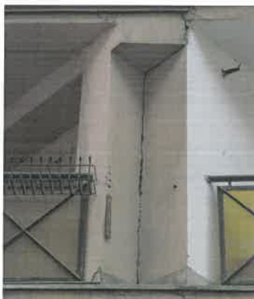
Fot. 4.21 – Stwierdzono brak elastycznego wypełnienia dylatacji od strony elewacji frontowej - Igielna 8 i 9
