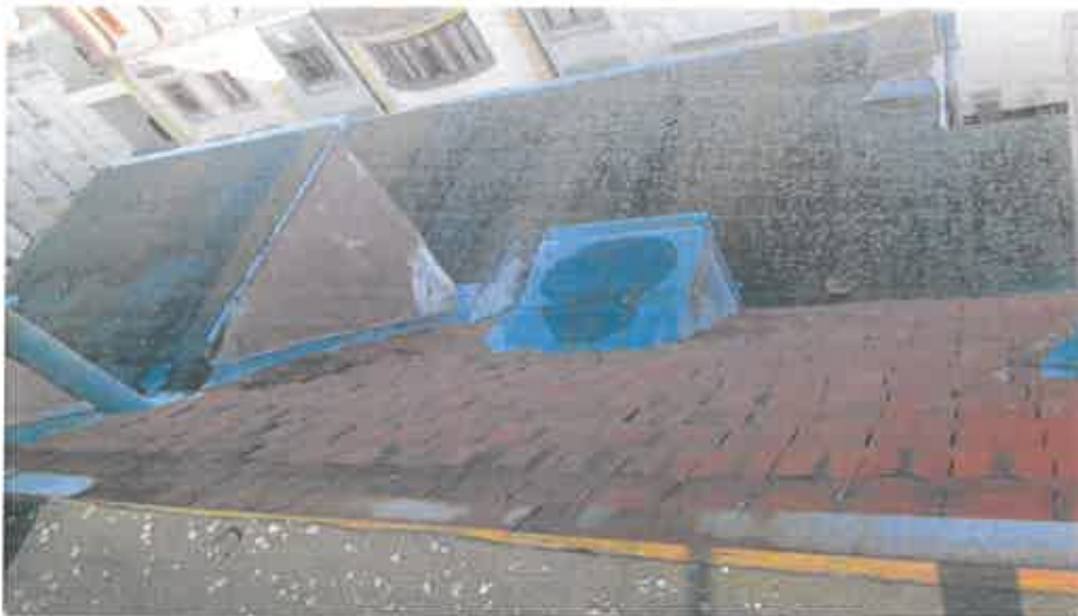
Fot. 4.5. Pokrycie z papy termozgrzewalnej jest spękanе, lokalnie odparzone, z ubytkami posypki oraz skorodowane biologicznie
