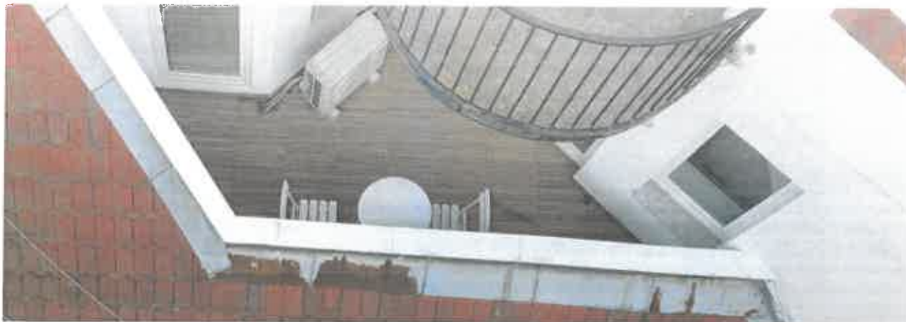
Fot. 4.11. Na tarasie wykonanym na poziomie dachu (od strony ul. Igielnej) nie stwierdzono nieprawidłowości
