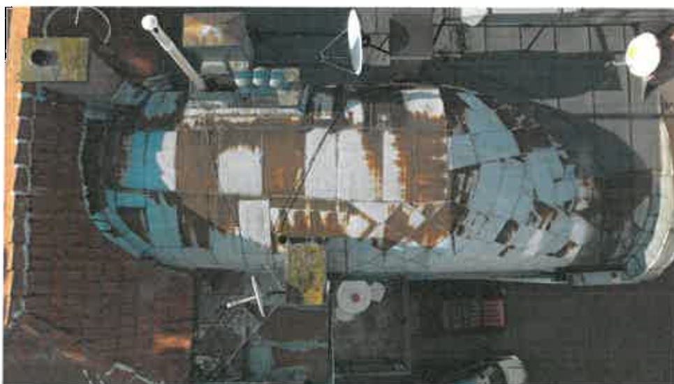
Fot. 4.7. Pokrycie z blachy gładkiej jest skorodowane powierzchniowo i miejscami wżerowo (podobnie pozostałe obróbki blacharskie dachu oraz rynny)
