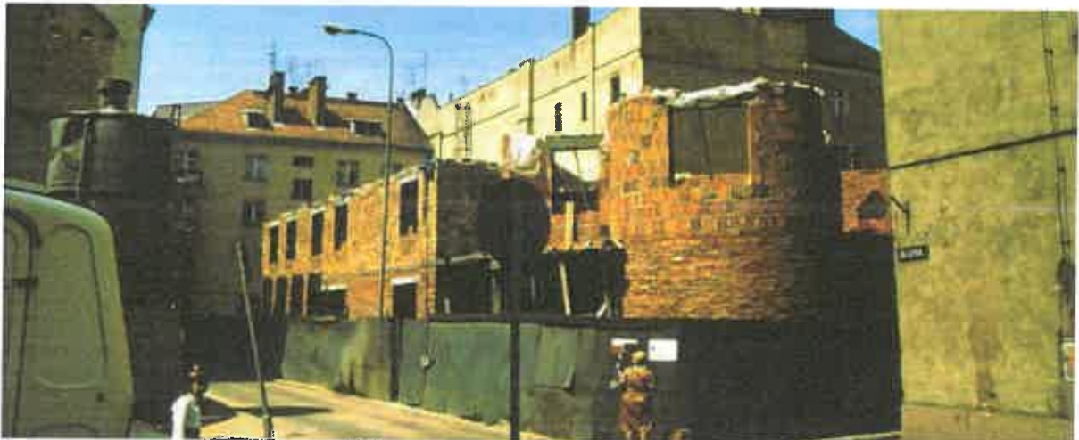
Fot. 3.5. Widok konstrukcji ścian z cegły dziurawki i pustaków – narożnik Więzienna/Igielna – zdjęcie z 1989 r.
