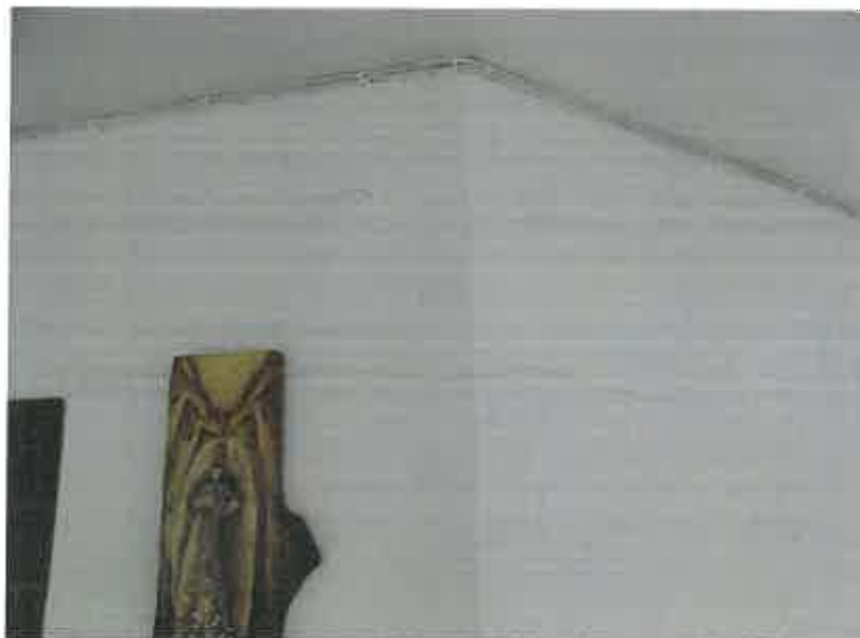
Fot. 4.12 – zarysowania ścian konstrukcyjnych w rejonie wejść do lokali mieszkalnych (lok 14) na elew frontowej, na galeriach.
