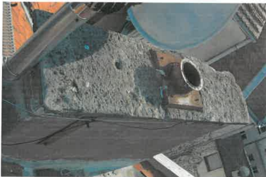
Fot. 4.10. Betonowe czapy kominowe są zwietrzałe i skarbonatyzowane, na niektórych kominach częściowo odspojone
