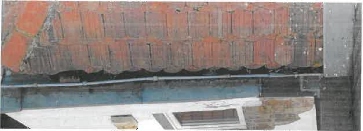
Fot. 4.8. Część rynien dachowych jest odkształcona, w związku z tym dochodzi w nich do zastoin wodnych
