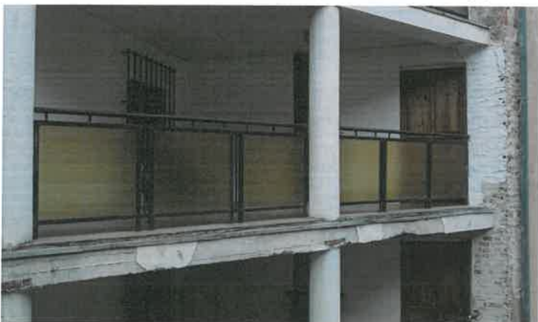
Fot. 4.26 – Odspojenia tynków i lokalnie otuliny betonowej na podciągu i słupach galerii – elew front
