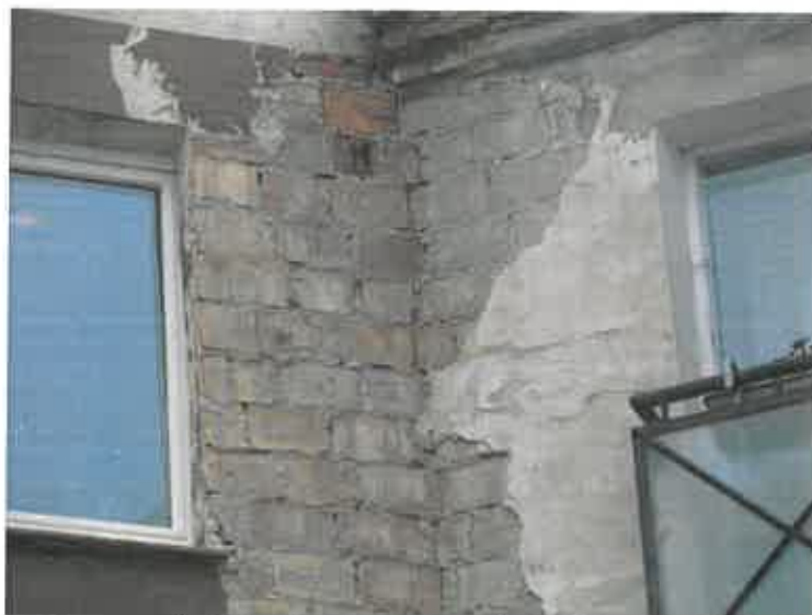
Fot. 4.22 – Na elewacjach i gzymsach stwierdzono zarysowania tynków oraz lokalne ich odspojenia – elew tył
