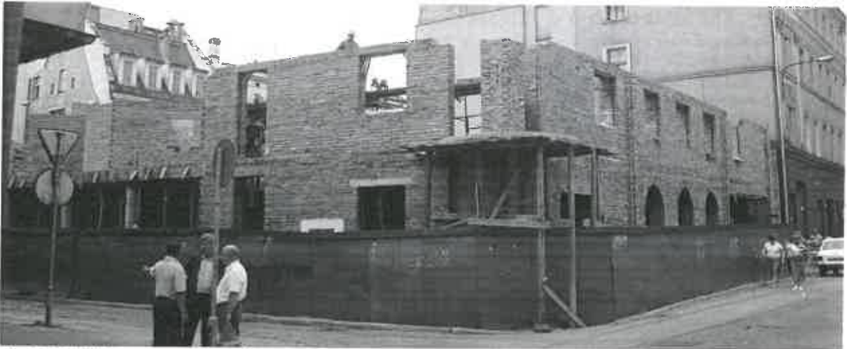
Fot. 3.4. Widok konstrukcji ścian z cegły dziurawki – narożnik Więzienna/Kotlarska – zdjęcie z 1989 r.
