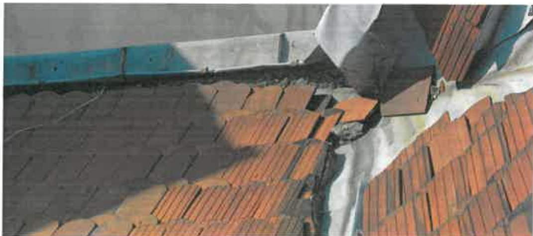
Fot. 4.1. Odspojone dachówki (obecnie uprzętnięte) oraz zastoiny w rynnie
