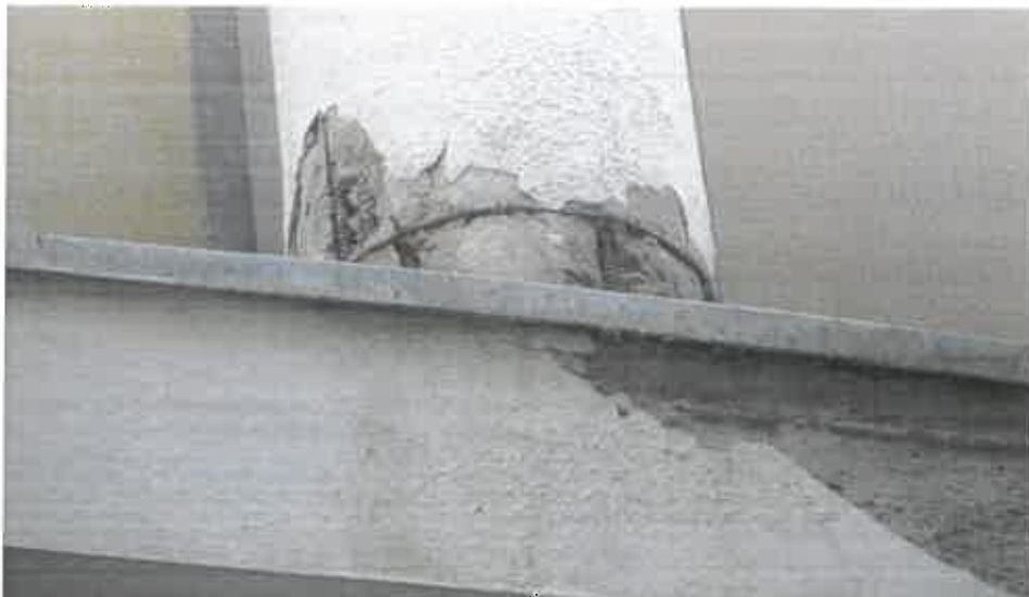
Fot. 4.27 – Odspojenia tynków i lokalnie otuliny betonowej na podciągu i słupach galerii – elew front
