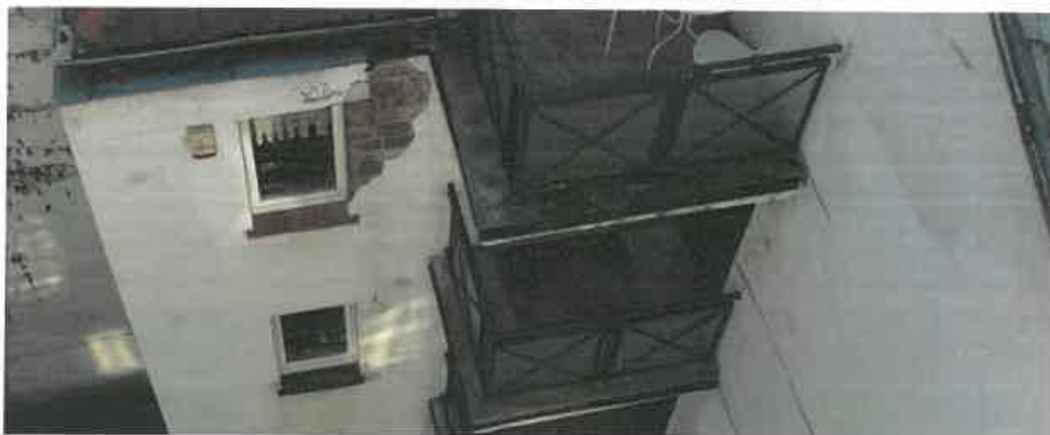
Fot. 4.23 – Na elewacjach i gzymsach stwierdzono zarysowania tynków oraz lokalne ich odspojenia – elew tył
