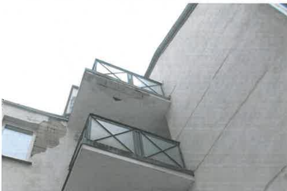
Fot. 4.28 – Odspojenia tynku na spodzie balkonu na najwyższej kondygnacji, Igielna 8 – elew tył
