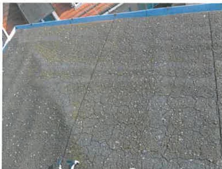
Fot. 4.6. Pokrycie z papy termozgrzewalnej jest spękanе, lokalnie odparzone, z ubytkami posypki oraz skorodowane biologicznie
