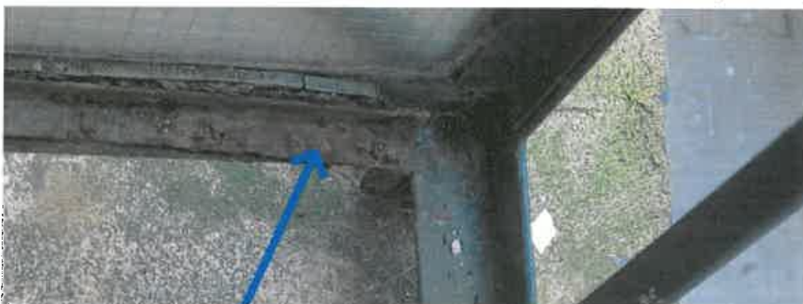
Fot. 4.31 – Na niektórych balustradach stwierdzono korozję listew dociskowych mocujących szkło do ramek
