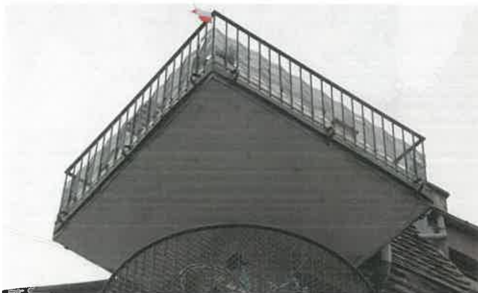
Fot. 4.29 – Lokalne zawilgocenia tynku na spodzie balkonu na najwyższej kondygnacji, Więzienna/Kotlarska – elew front
