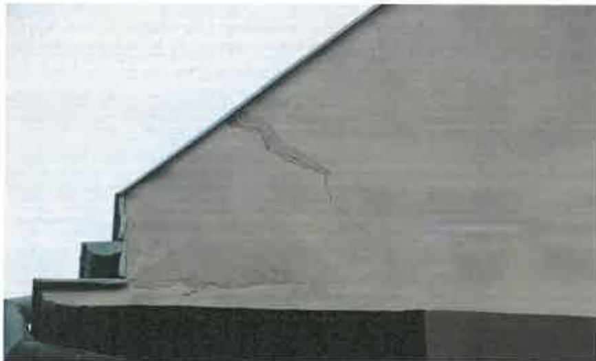
Fot. 4.25 – Na elewacjach i gzymsach stwierdzono zarysowania tynków oraz lokalne ich odspojenia – elew szczyt
