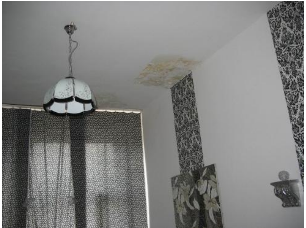
Fot.41 Widok na lokalny zaciek
