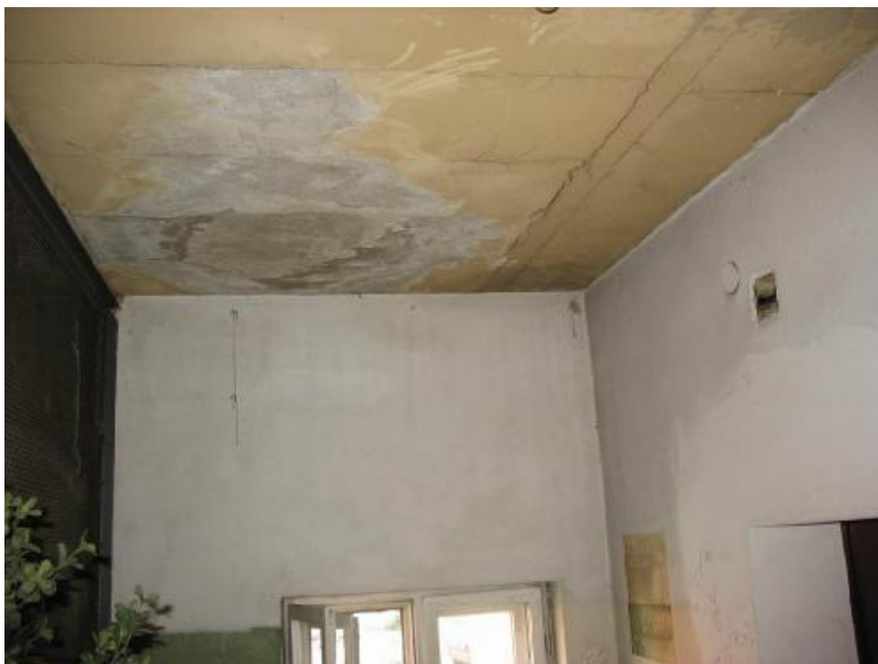
Fot.61 Widok na zaciek stropodachu, który został uszczelniony
