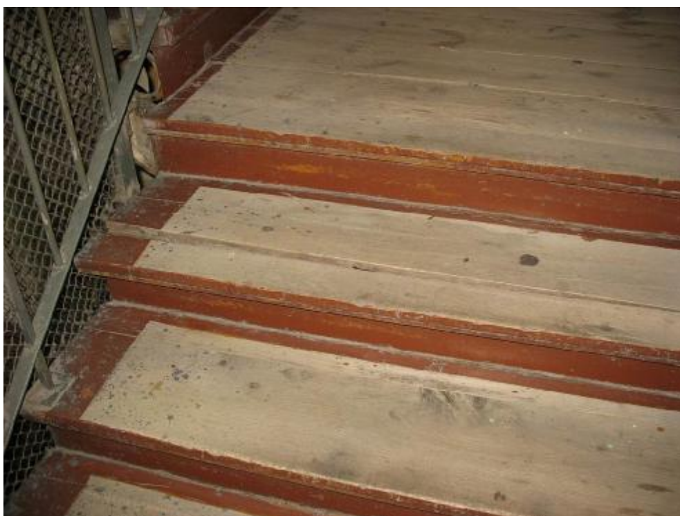
Fot.62 Widok na uszkodzone stopnice schodów
