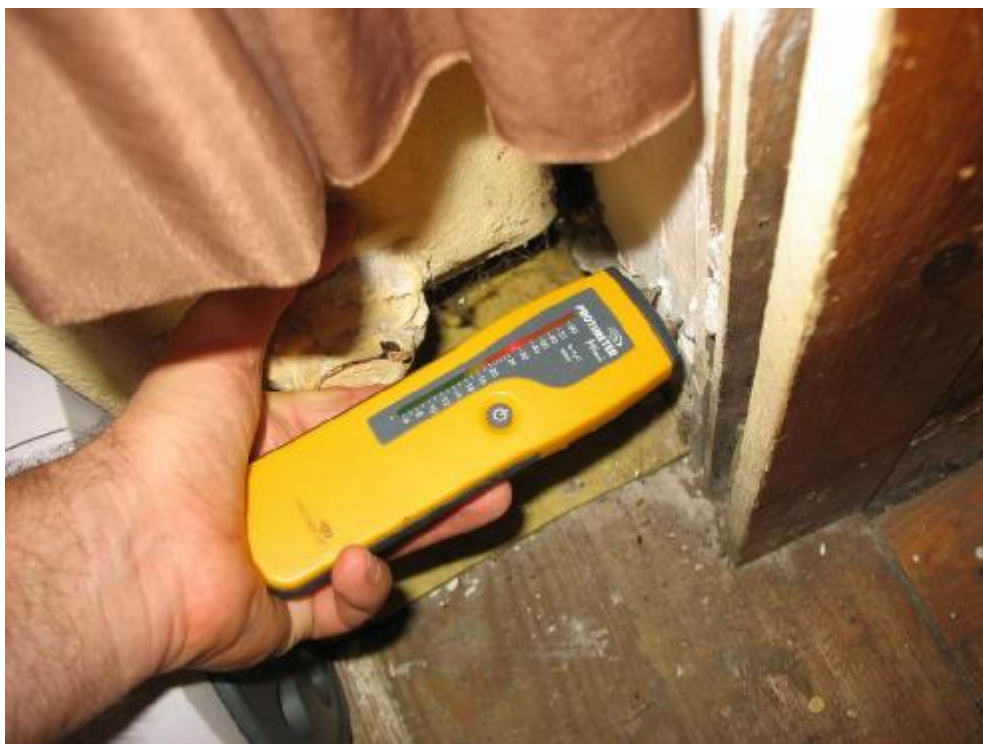
Fot.31 Badania zwilgocenia ściany - odczyt 28 - wilgotność masowa 7,5% - ściana zawilgocona
