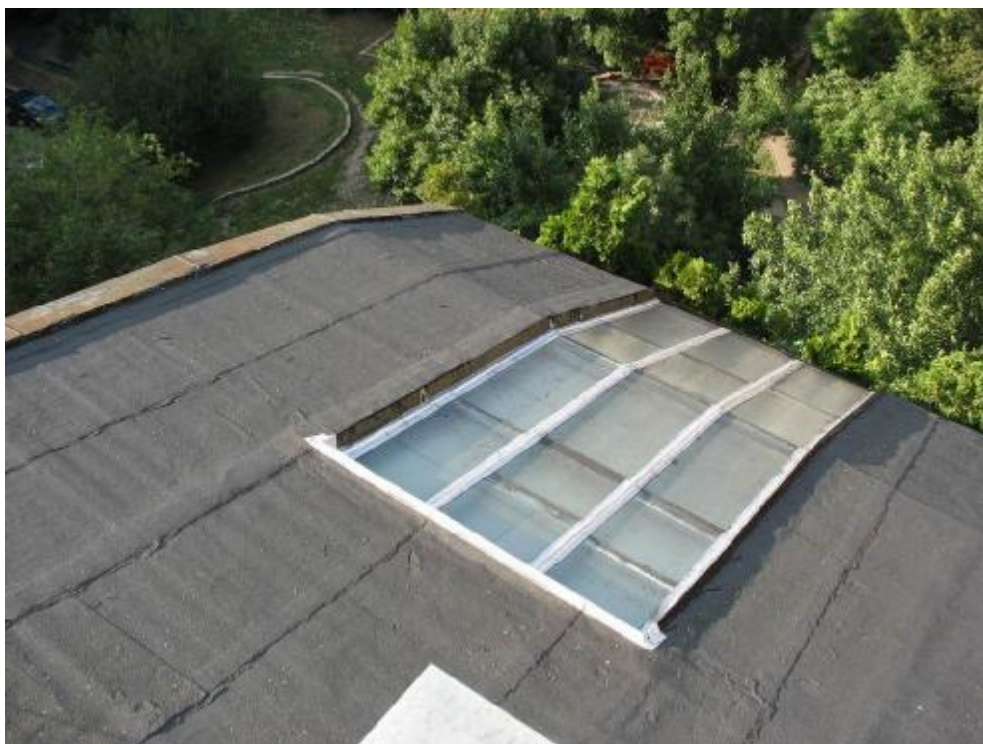
Fot.69 Widok na dach mieszkania nr 15 – stwierdza się brak docieplenia stropodachu
