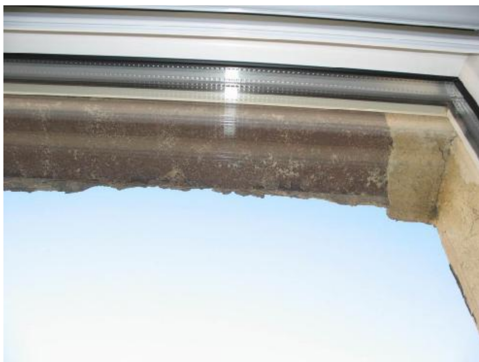
Fot.52 Widok na uszkodzone nadproże nad oknem
