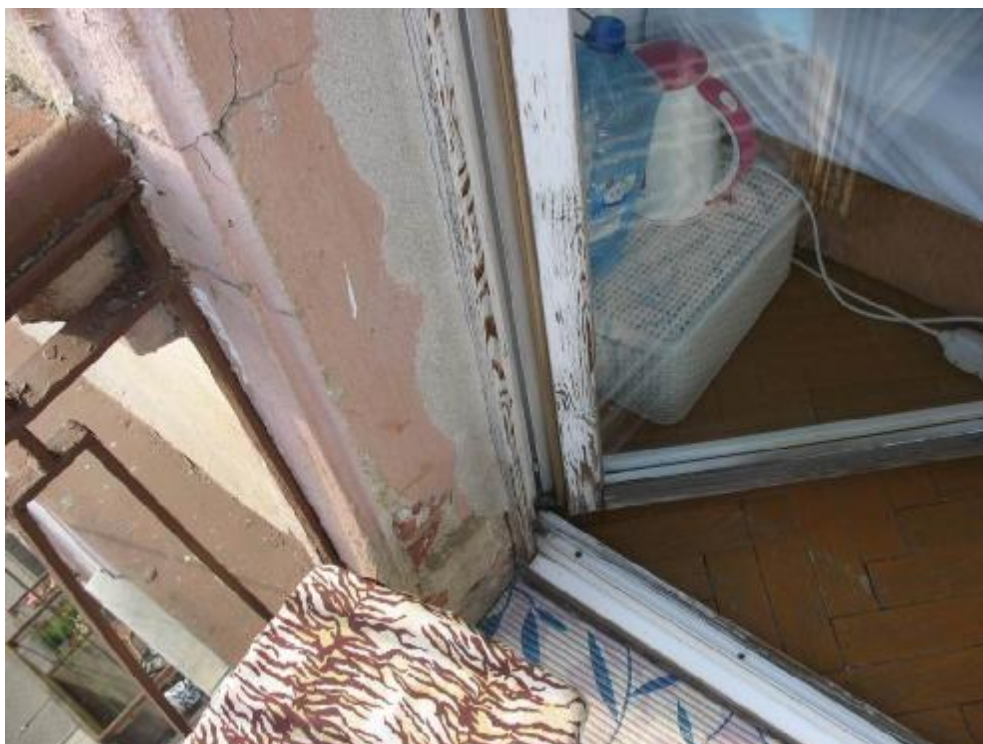
Fot.43 Widok na zarysowanie ściany przy balkonie
