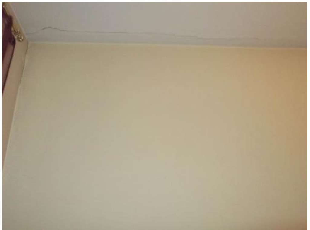
Fot.28 Widoczne zarysowanie stropu
