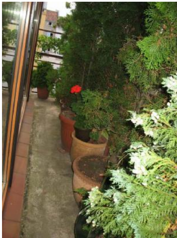
Fot.46 Widok na postawione donice w części wspornikowej stropu. Donice obciążają gzyms
