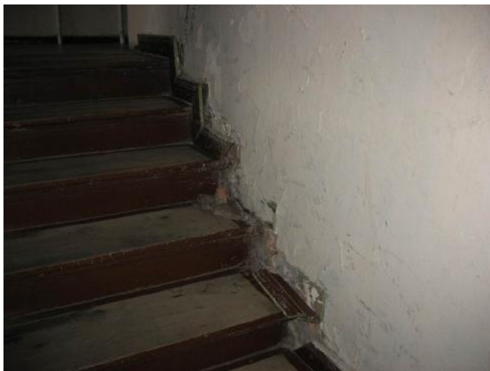
Fot.60 Widok na uszkodzone stopnice schodów
