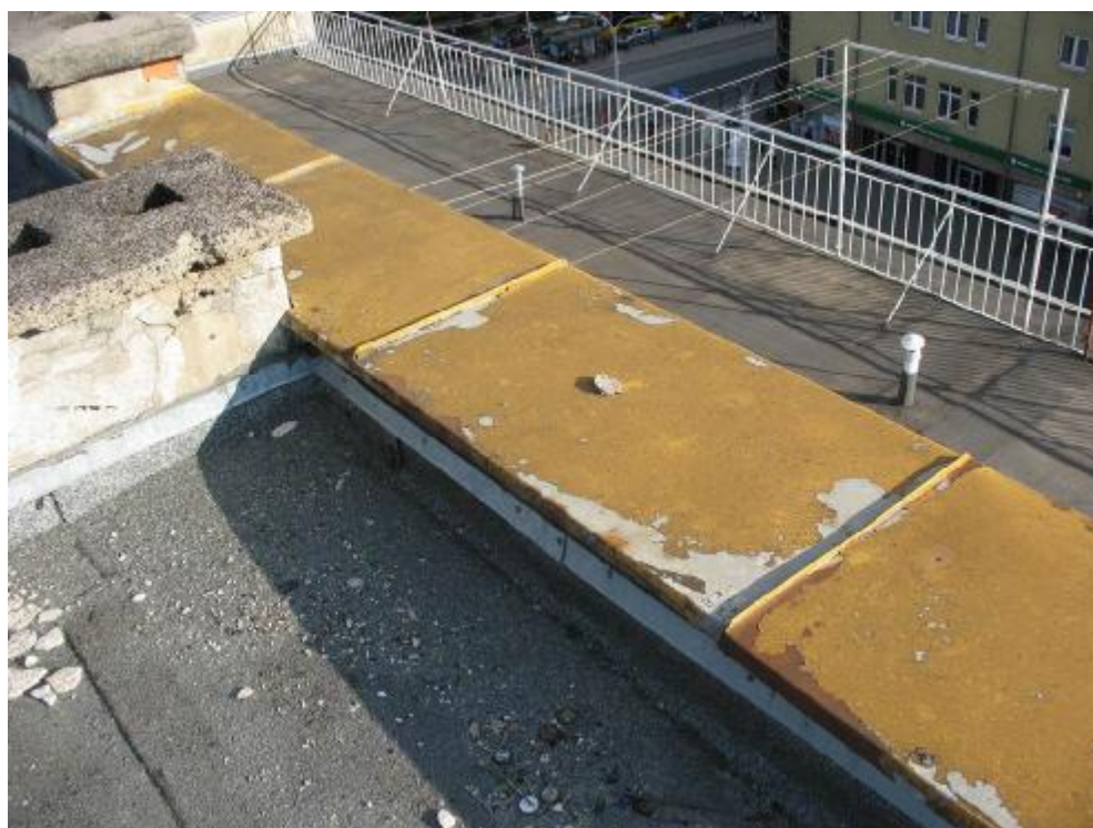
Fot.68 Widok na uszkodzone obróbki blacharskie
