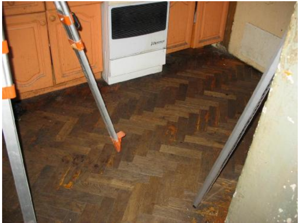
Fot.33 Posadzka z parkietu zniszczona
