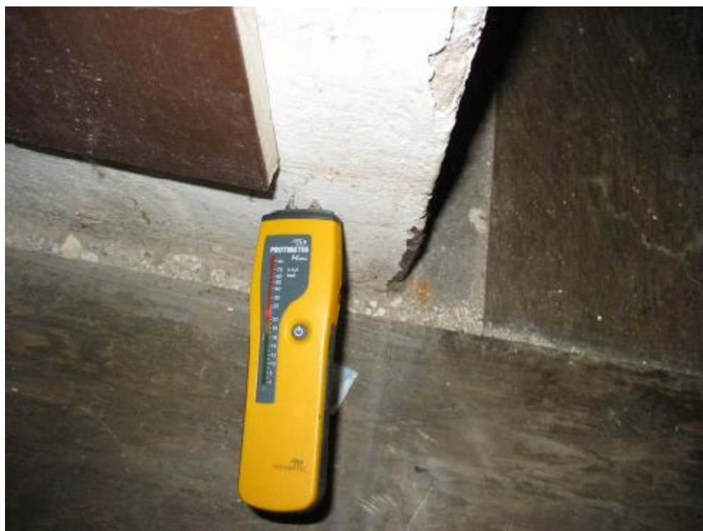
Fot.17 Badania zwilgocenia ściany - odczyt 23 - wilgotność masowa 6,2% - ściana zawilgocona
