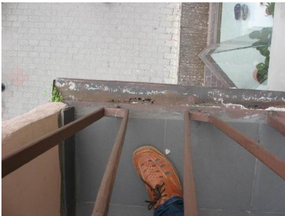
Fot.21 Skorodowane obróbki blacharskie balkonu
