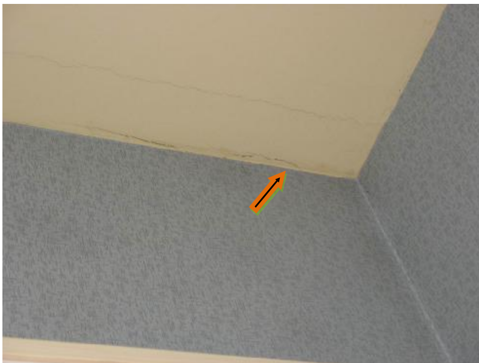
Fot.21A Widok na narożnik ściany szczytowej Strzałka pokazuje miejsce odwarstwienia się stropu
