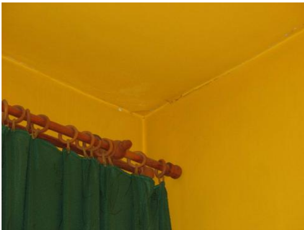
Fot.37 Widoczne zarysowanie stropu przy połączeniu ze ścianą szczytową
