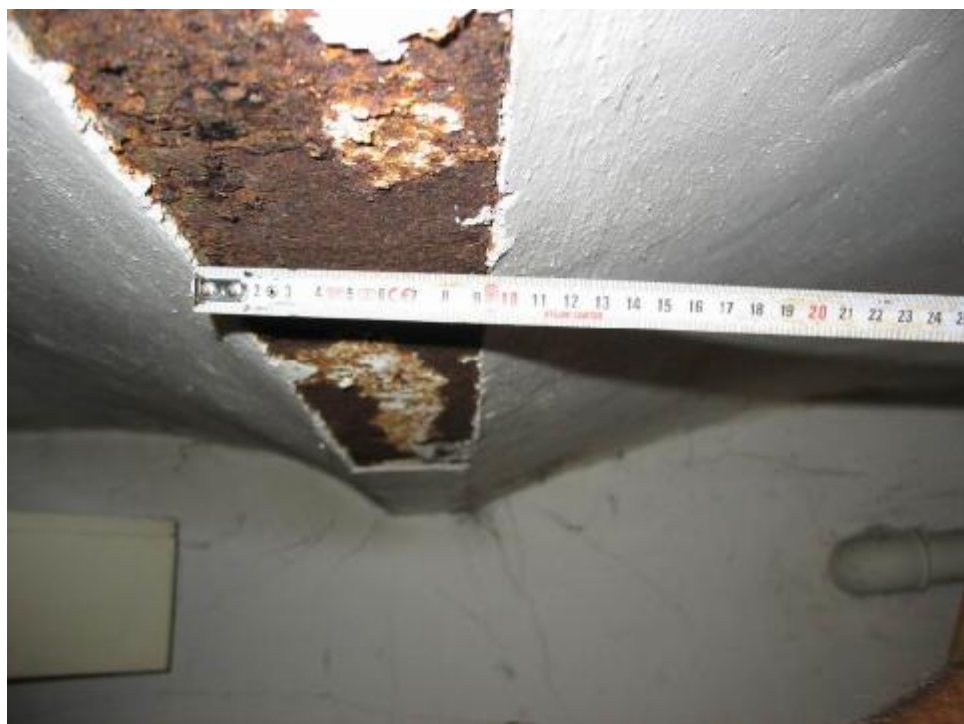
Fot.7 Widok na skorodowane belki dwuteownika – wykonane obliczenia statyczne potwierdzają jednak, że nośność stropu jest zapewniona – podciąg P3
