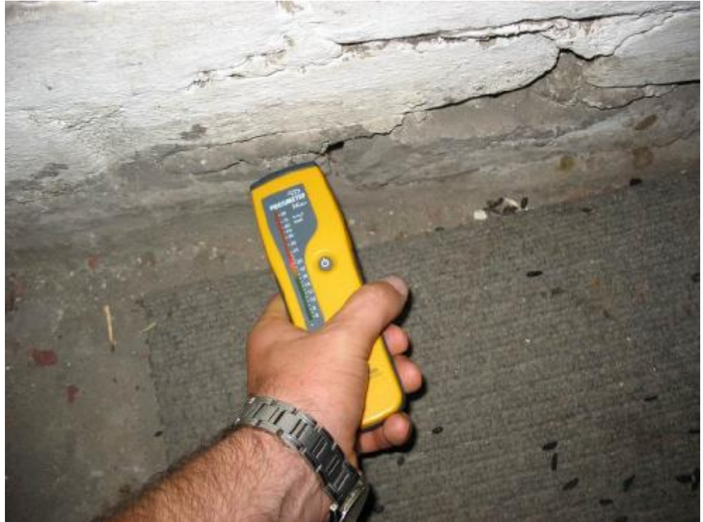
Fot.13 Badania zwilgocenia ściany - odczyt 22 - wilgotność masowa 6,0%- ściana zawilgocona
