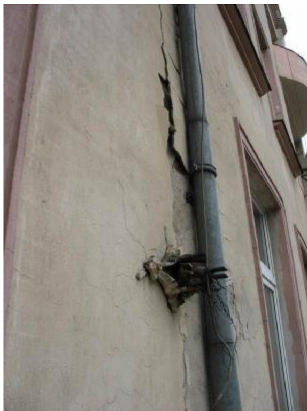
Fot.20 Widok na odparzony tynk elewacji
