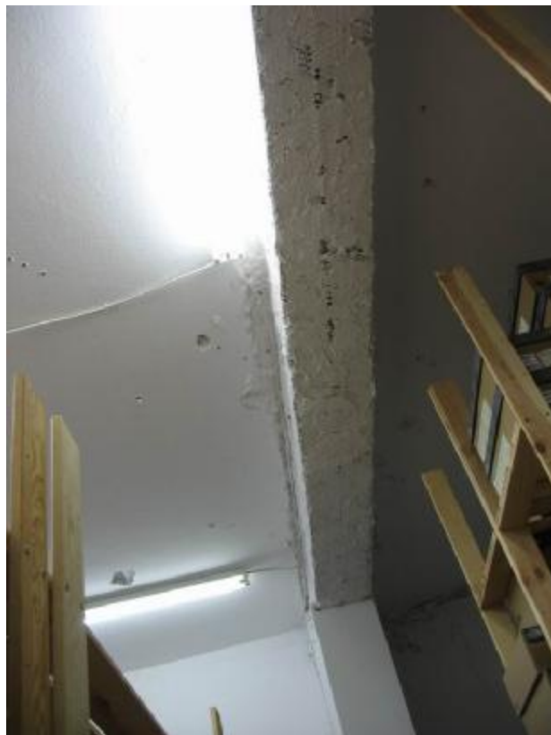
Fot.16 Widok na podciąg typu P2. Wykonane obliczenia statyczne potwierdzają jednak, że nośność stropu jest zapewniona
