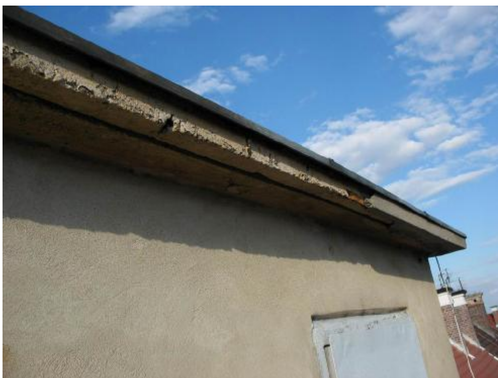
Fot.70 Widok na uszkodzony gzyms
