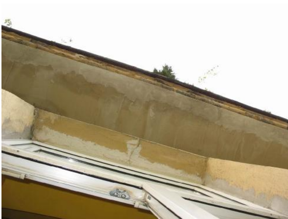
Fot.38 Widok na zarysowane nadproże i zawilgocony gzyms
