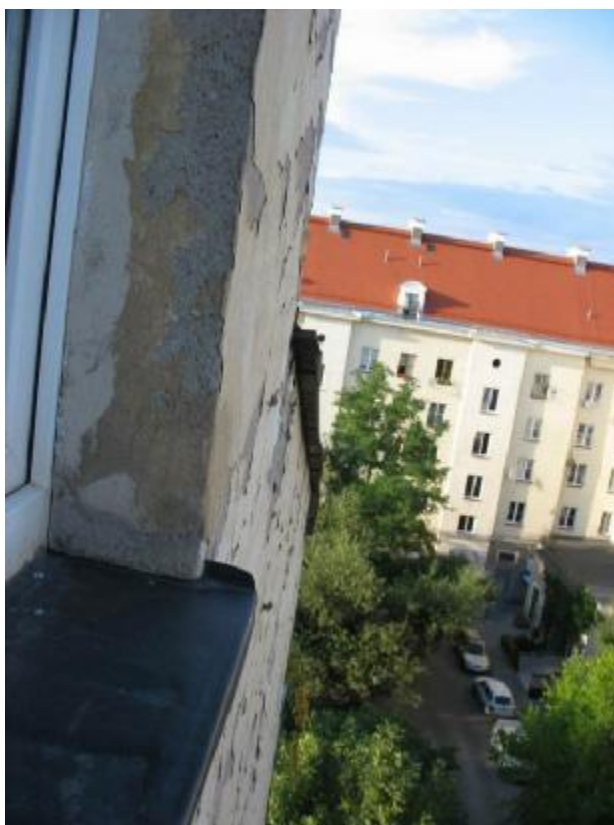
Fot.54 Widok na uszkodzoną fakturę tynku ścian elewacji
