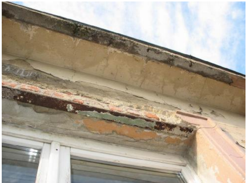
Fot.42 Widok na uszkodzone nadproże, belka stalowa skorodowana
