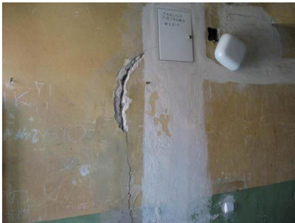
Fot.59 Widok na spękaną ścianę w obrębie klatki schodowej na poziomie poddasza
