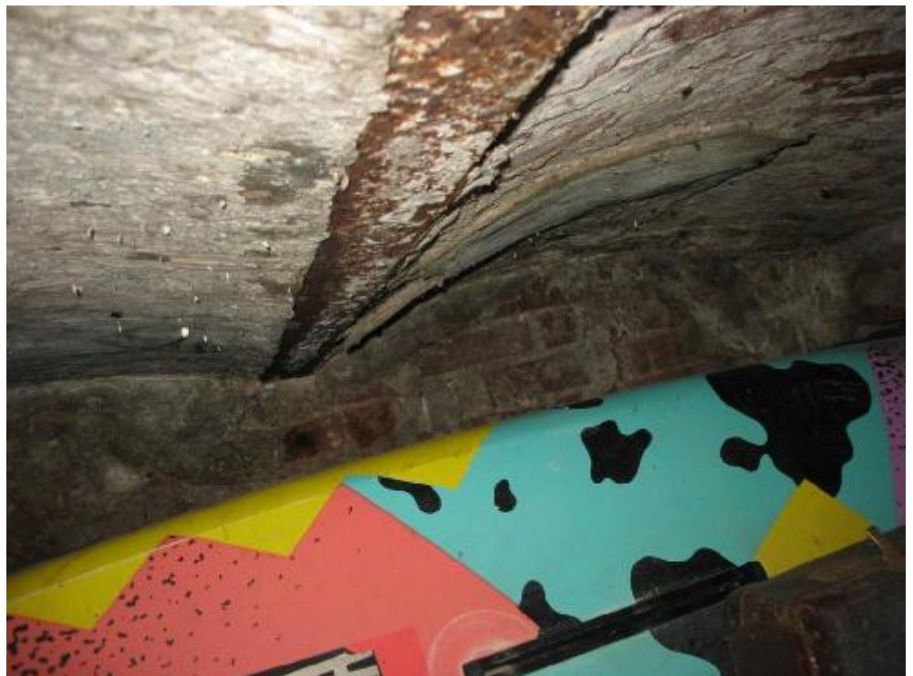
Fot.12 Komórka lokatorska nr 14 Widok na skorodowane belki dwuteownika – wykonane obliczenia statyczne potwierdzają jednak, że nośność stropu jest zapewniona – podciąg P6
