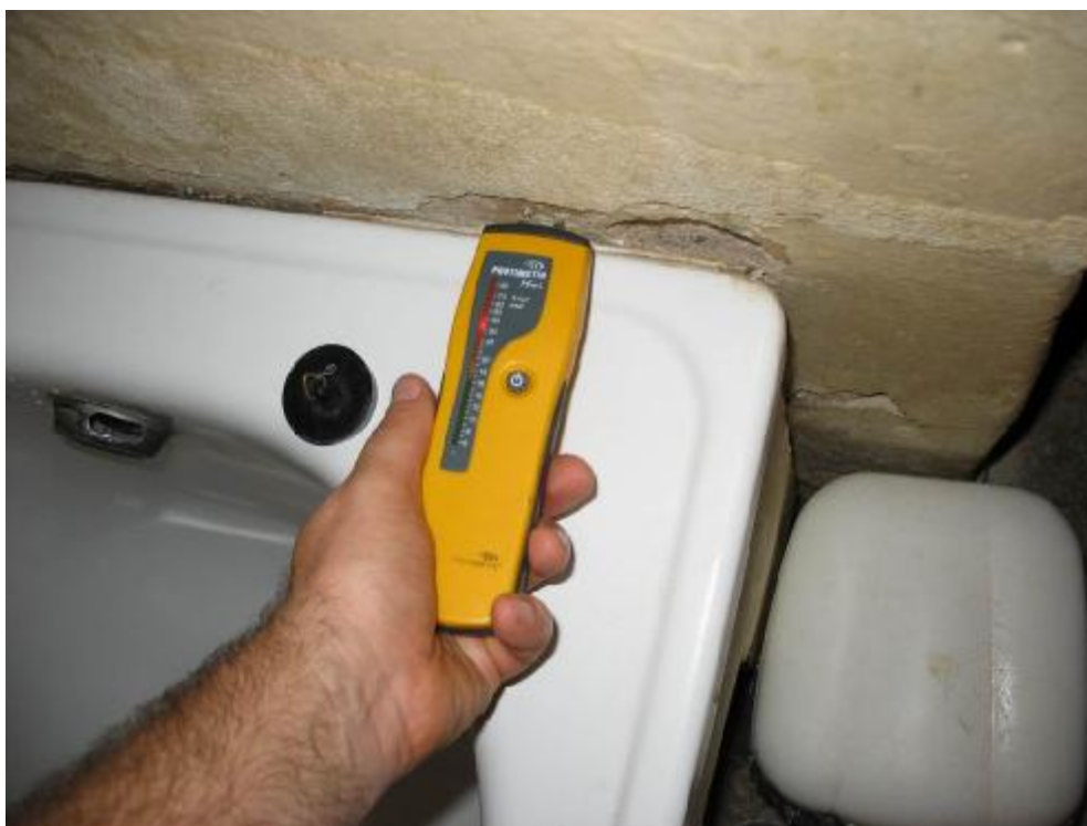
Fot.32 Badania zwilgocenia ściany - odczyt 35 - wilgotność masowa 10% - ściana zawilgocona
