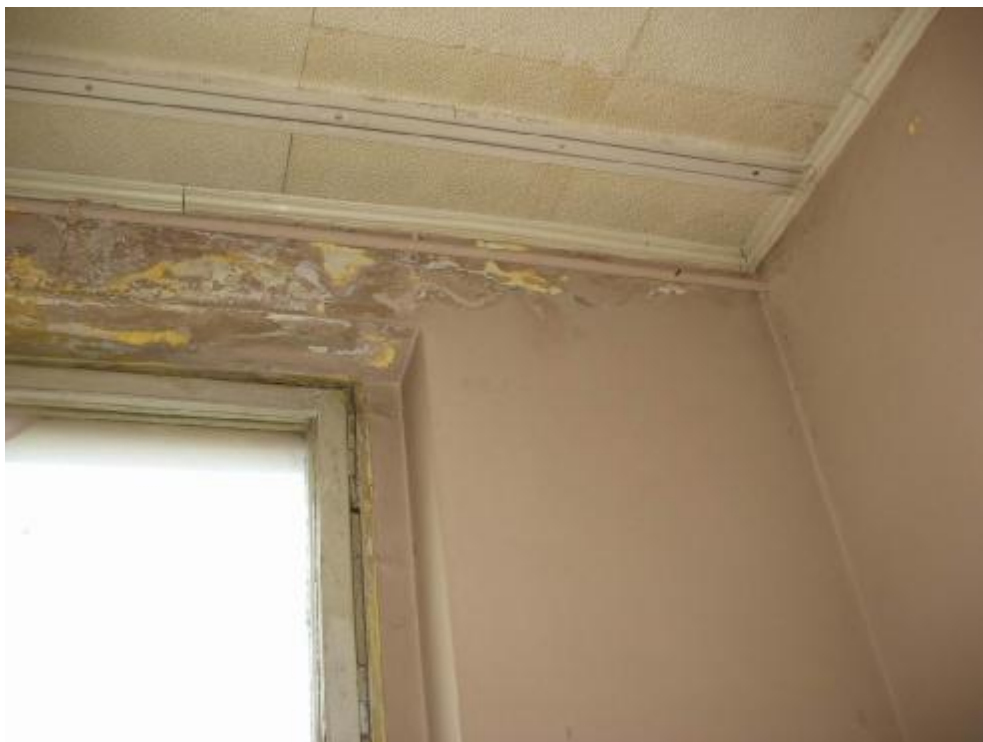
Fot.39 Widok na zawilgocone nadproże
