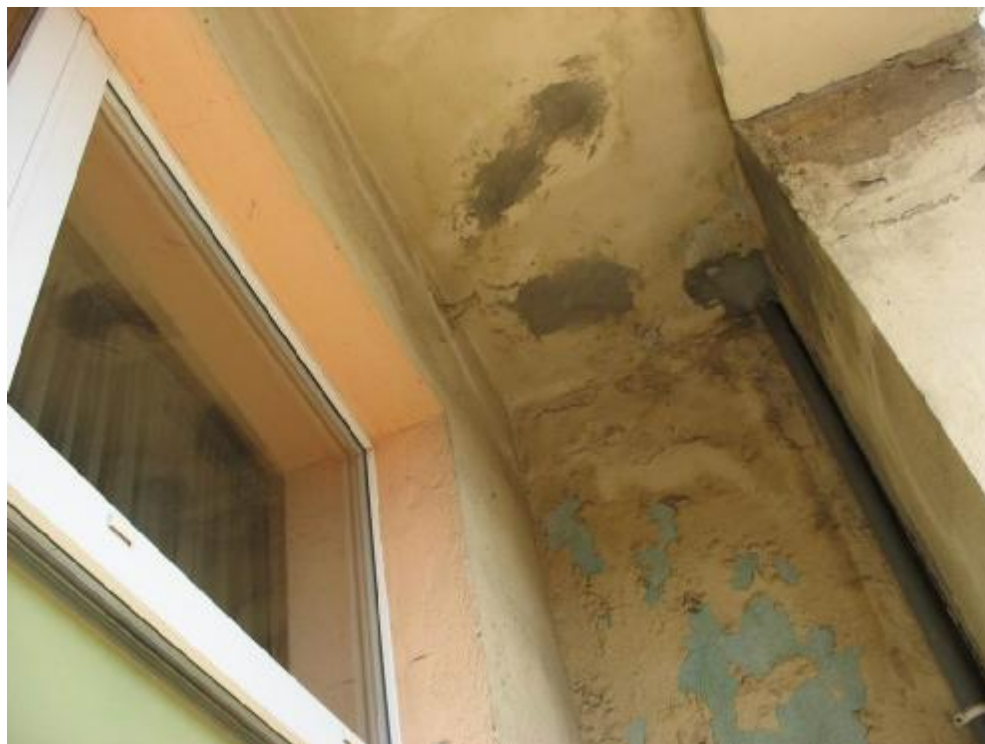
Fot.23 Zawilgocenie ścian loggi
