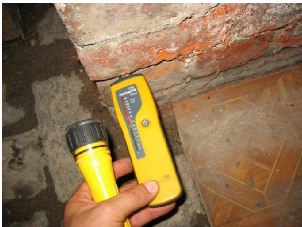
Fot.10 Badania zwilgocenia ściany - odczyt 25 - wilgotność masowa 6,8%- ściana zawilgocona
