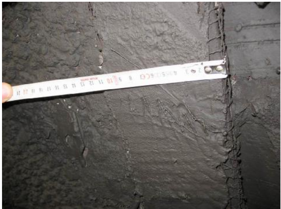
Fot.14 szerokość stopki dwuteownika ~10cm. Wykonane obliczenia statyczne potwierdzają jednak, że nośność stropu jest zapewniona – podciąg P1
