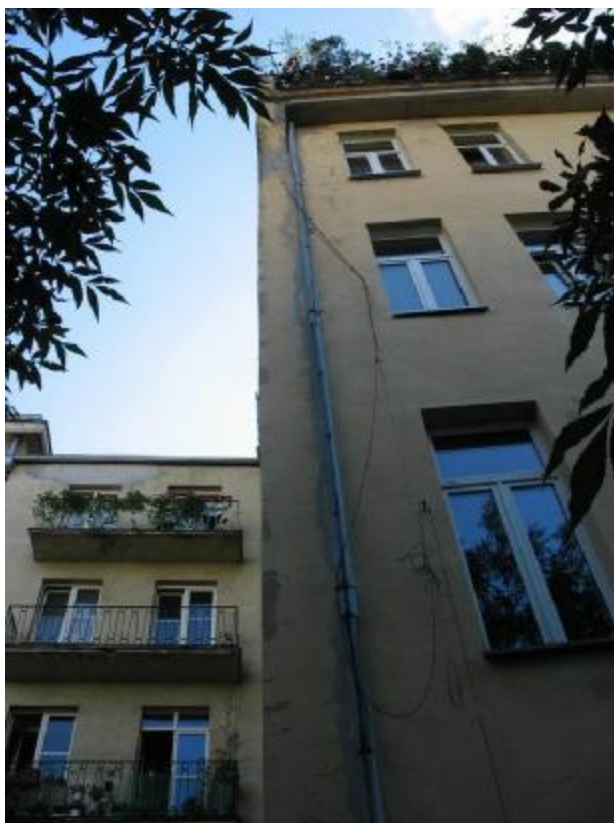
Fot.5 Widok na odwarstwienie się ściany szczytowej na całej wysokości budynku. Wg informacji lokatora ściana pierwotnie była podparta przyporą, co powodowało jej stateczność. Prawdopodobnie w latach 60-tych usunięto przyporę co znacznie osłabiło stateczność ściany
