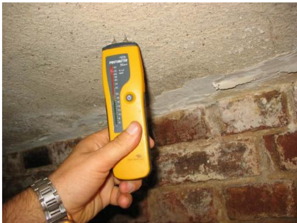
Fot.9 Badania zwilgocenia stropu - odczyt 75 - wilgotność masowa 18%- strop silnie zawilgocony
