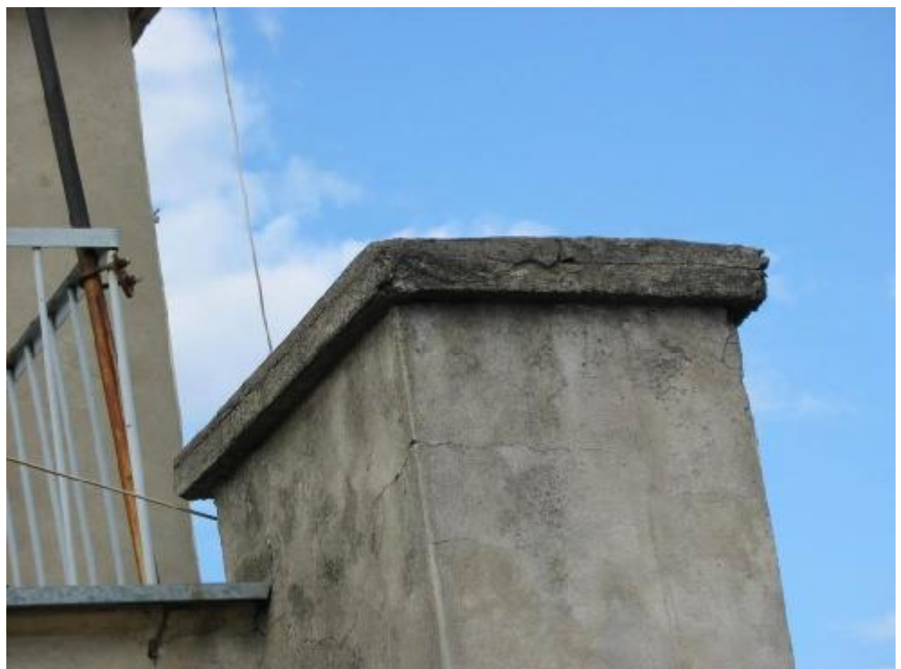
Fot.64 Widok na uszkodzone kominy
