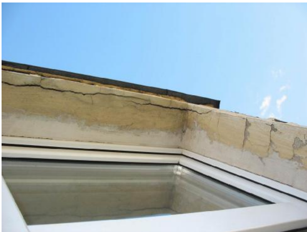
Fot.53 Widok na zarysowane nadproże nad oknem
