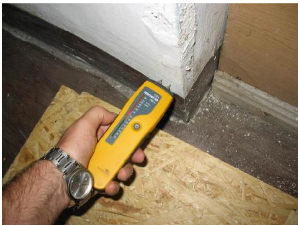
Fot.8 Badania zwilgocenia ściany – odczyt 25 – wilgotność masowa 6,8% - ściana zawilgocona
