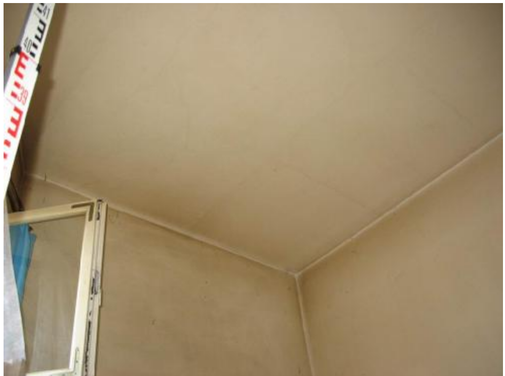
Fot.34 Widoczne drobne zarysowanie stropu
