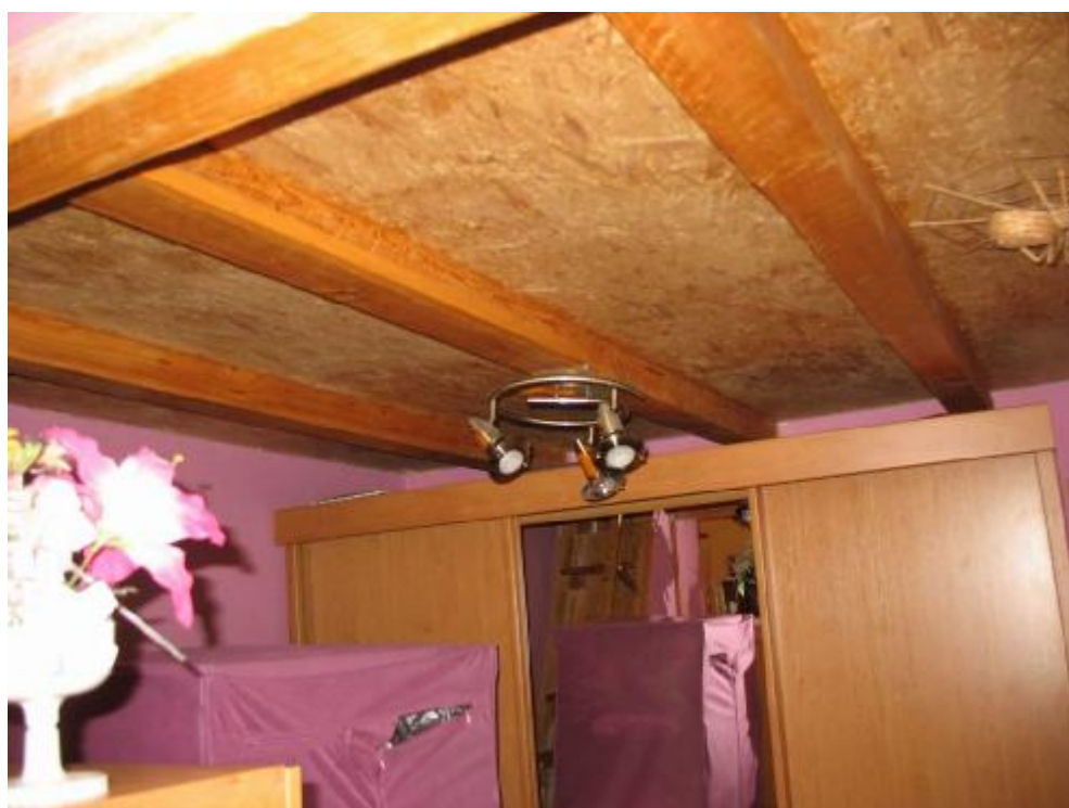
Fot.30 Widok na wykonaną prawdopodobnie nielegalnie antrsołę
