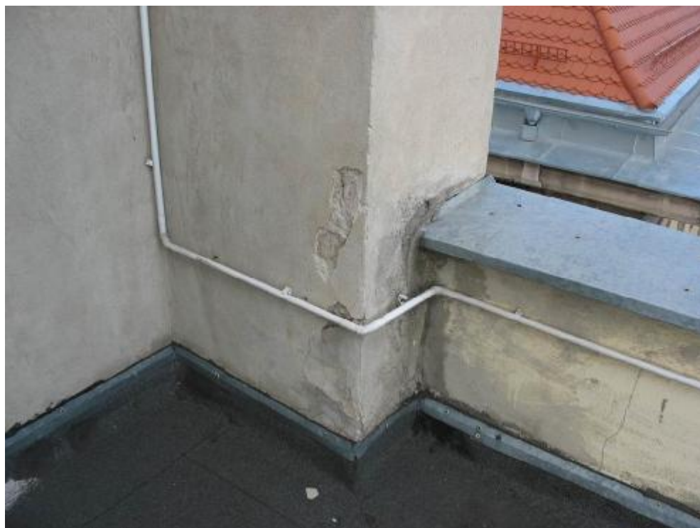
Fot.65 Widok na uszkodzone kominy
