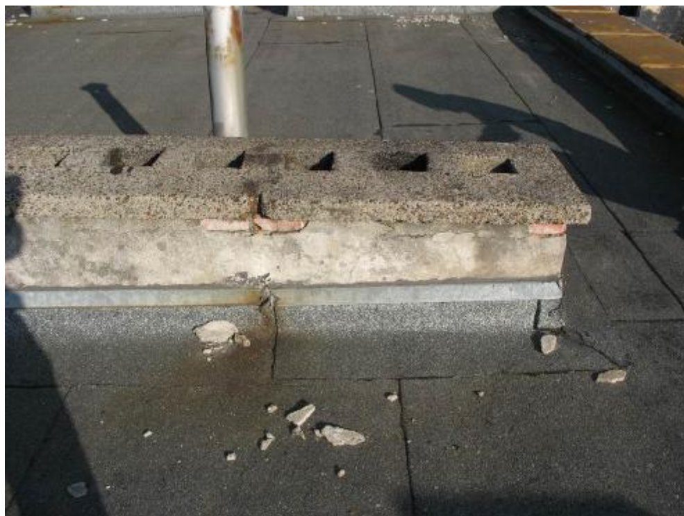
Fot.67 Widok na uszkodzone kominy
