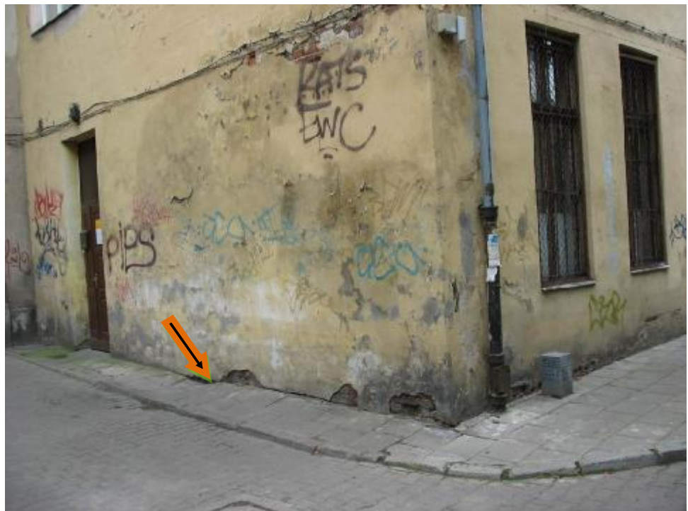
Fot.4 Elewacja zniszczona , tynki odparzone, zły stan techniczny obróbek blacharskich, uszkodzony chodnik, brak cokołu elewacji Strzałka pokazuje lokalizację wykonania odkrywki fundamentu wraz z badaniami geologicznymi gruntu
