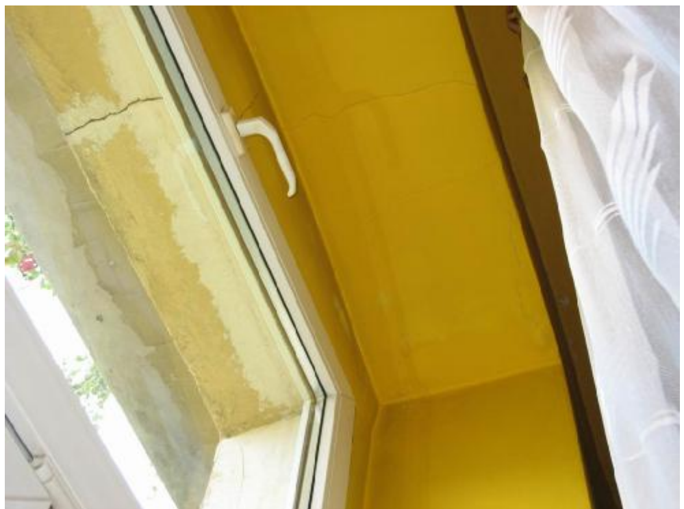
Fot.36 Widoczne zarysowanie ściany w obrębie okna
